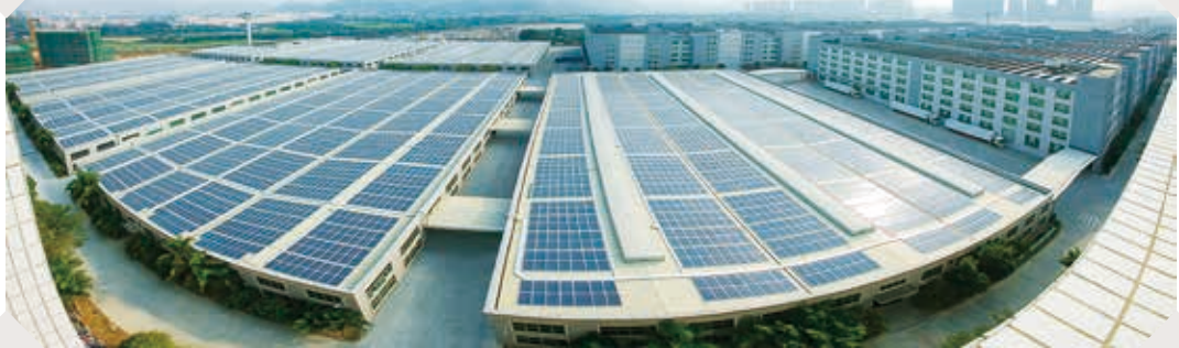
屋頂太陽能光伏發電系統
