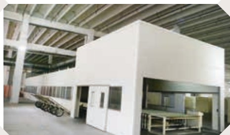
海綿發泡廢氣處理裝置2
