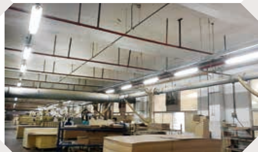
木工車間粉塵處理裝置2
