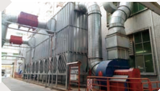
木工車間粉塵處理裝置1
