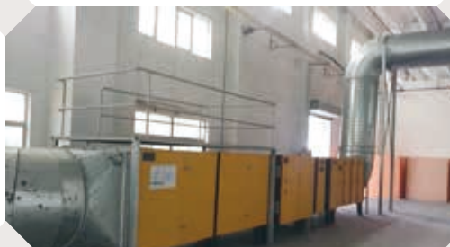
海綿發泡廢氣處理裝置1
